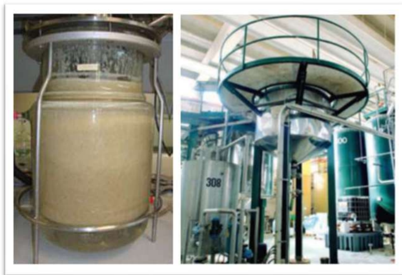
Impianto di idrolisi enzimatica presso ILSA
